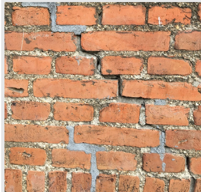
Gadefacade med sætningsrevne og partiel fugereparation.
