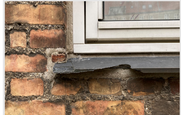
Sålbænk i gårdfacade med kraftig afskalning.
