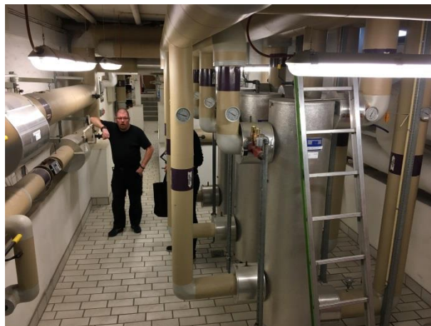
Varmecentral i kælder.
