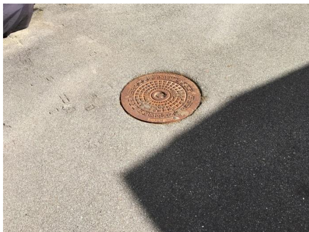
Kloakdæksel i terræn.
