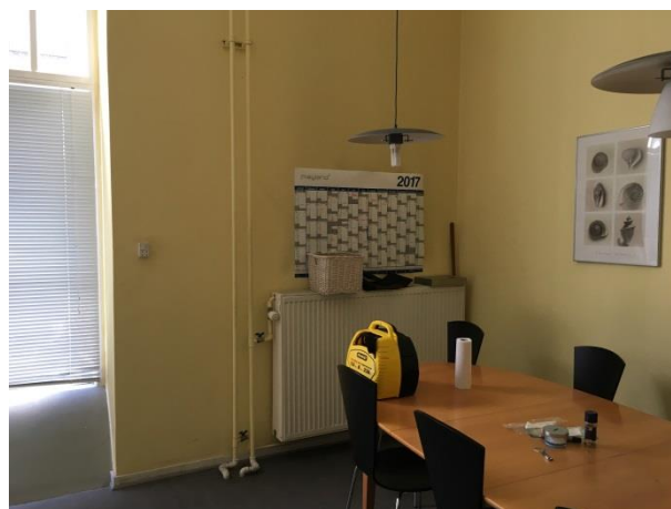
Radiator ud ved facaden.
